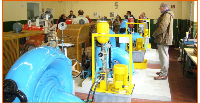
Freie Wähler besichtigen 2010 Wasserkraftwerk in Guntersdorf
